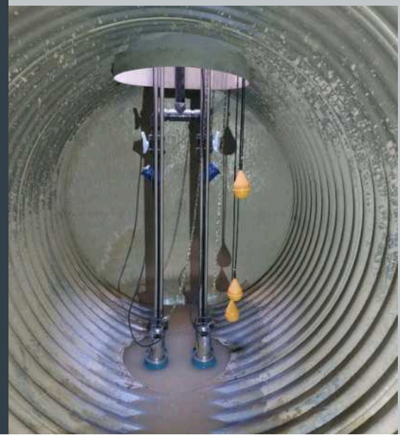
Groupe de pompage dans caisson
