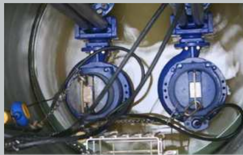
Groupe de pompage avec arrêt en cas de pollution (ouvrage mixte)
