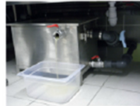
2 - fermer la vanne bleue ouvrir la vanne "graisses"
